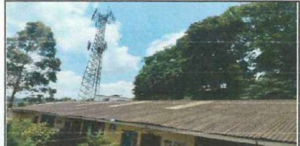
Foto 2: Angulo opuesto del entechado que se debera cambiar y la substitución sera de láminas acanaladas por troqueladas calibre 26.
