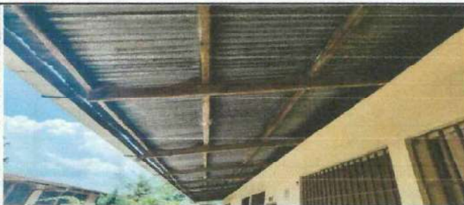
Foto 3: Vista interior de el corredor de dicho pasio el cual cuenta actualmente con agujeros y es por ahí donde ingresa el agua cuando llueve.
