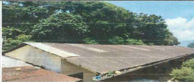
Foto1: Es necesario el cambio de la lámina que tiene dicho modulo. Debido a que tiene aproximadamente más de 20 años y ya llevo a su tiempo de vida útil, además ya estan en malas condiciones. Ingresa agua por los agujeros en época de invierno.
